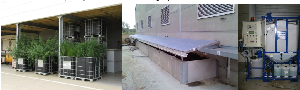
Figuur 1: Verschillende zuiveringssystemen voor restwater. Van links naar rechts biofilter, fytobak en sentinel
