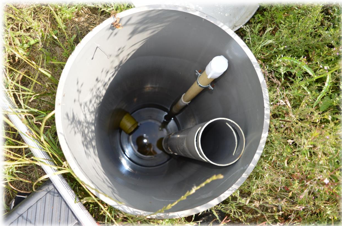
Figuur 45. – Verzamelput of peilput. Rechts: pvc-regel- of peilbuis, gemonteerd op de ondergrondse verzamelbuis. Links: gele overloop buis naar de gracht.
