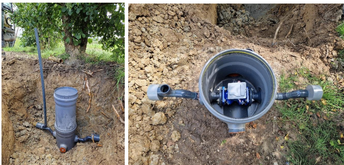
Figuur 52 Ultrasone watermeter geïnstalleerd op de moerbuis van een gedraineerd perceel, die hiervoor onderbroken werd.
