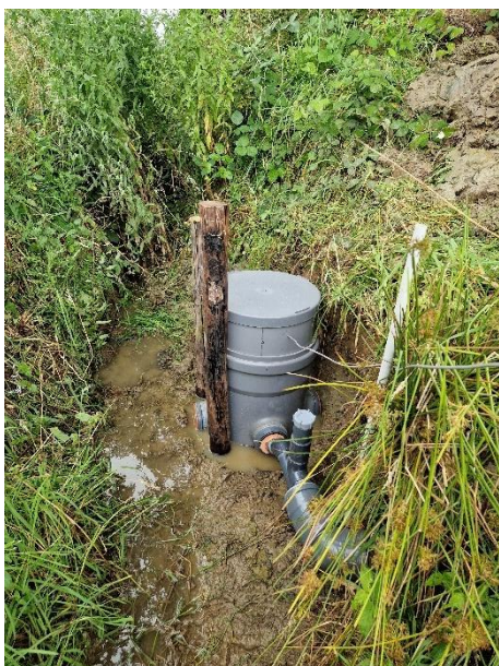
Figuur 53 Ultrasonische watermeter geïnstalleerd op de moerbuis vlak voor het water uitloopt in de gracht.
